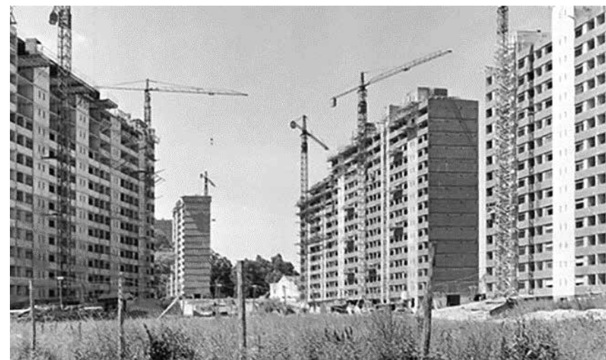
FIGURA 9. FOTOGRAFÍA DEL PARQUE POSADAS EN CONSTRUCCIÓN. DOCUMENTO QUE PERTENECÍA A JULIO CÉSAR ABELLA TRÍAS. ARCHIVO DE LA LIGA DE LA CONSTRUCCIÓN DEL URUGUAY.
