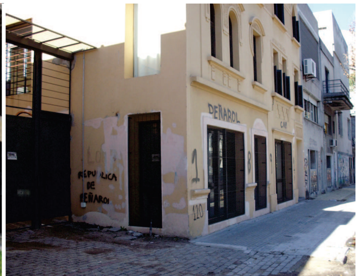
deterioro de pintura de fachada
